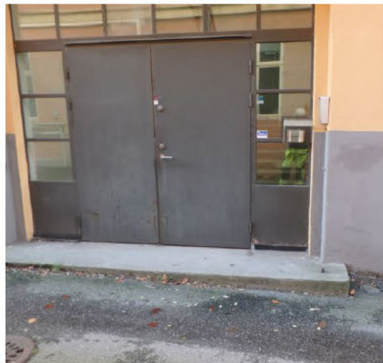
Bilde nr. 10 Viser ståldør til vareheis, rustskader
