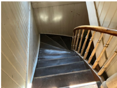
Manglende håndrekke og store gliper på rekkverk/spiler
