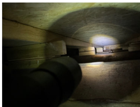
Glippe mellom «gammelt» og «nyere» del av taket.
