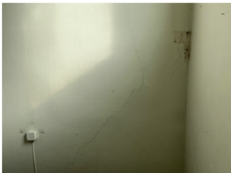
Eksempel på riss/sprekk og slitasje i trappegang
