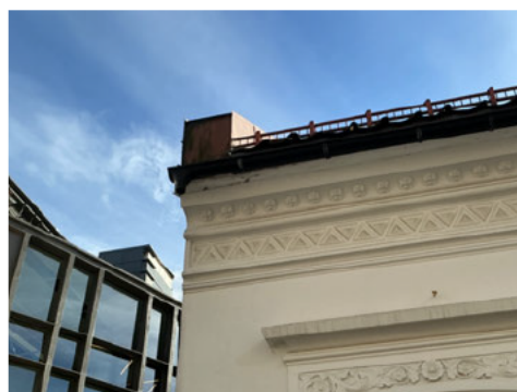
Mangler nedløp mot gate
