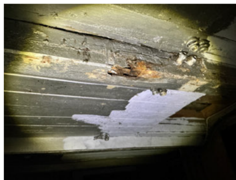
Råteskadet bjelke i kjeller
