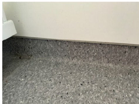
Ikke fuget overgang mot bunnlist
