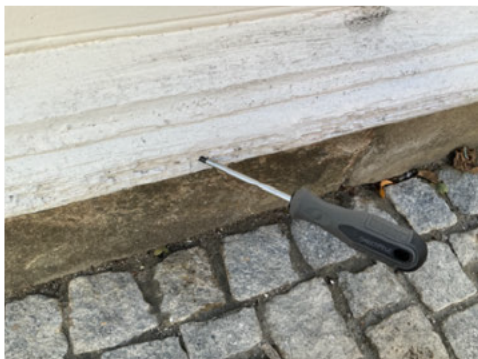
Bunnstokk har stedvis slitasje og tegn til mykt treverk
