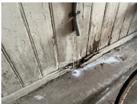
Inne i yttergang er det et område med råteskade
