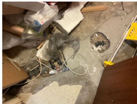
Synlig tegn til at gulv i kjeller er pigget opp og avløp skiftet
