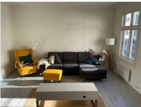
I 2 etasje er det varierende alder, slitasje og standard på overflater.
