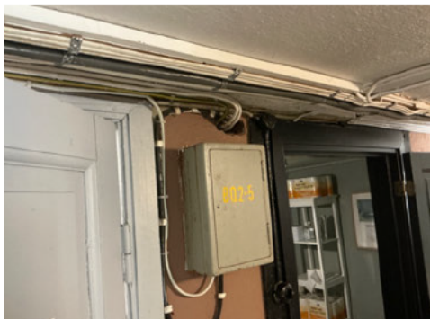
Variierende alder på el-anlegget
