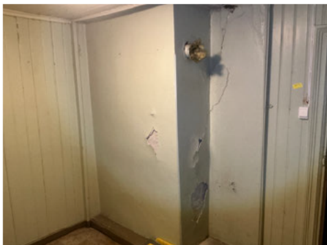
På loftetasje er det ovnsrør fra oven som er fjernet og sprekker på pipe/overflater
